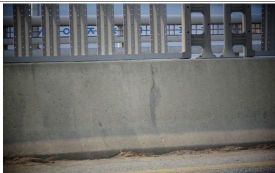
S24 중분대 균열 (양평방향)
