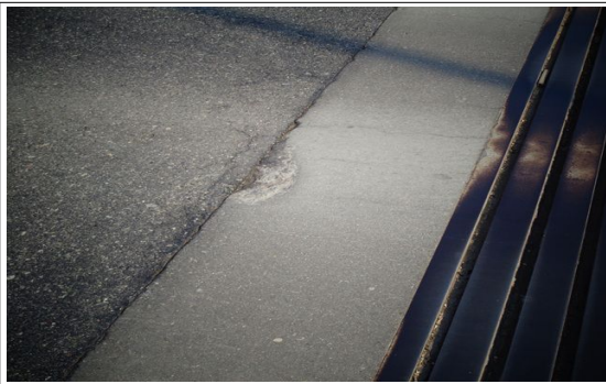
P11 후타재 파손 (원주방향)
