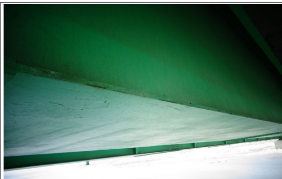
S24 부식 및 도장박리 (원주방향)
