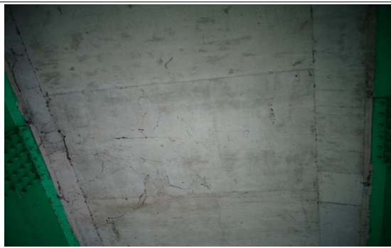
S31 폭 0.3mm미만 균열 (양평방향)
